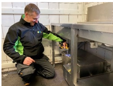
Contrôle régulier de l'équipement par un technicien de service
